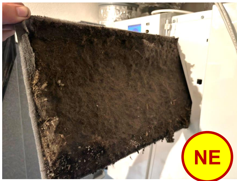
Zanedbaný a znečištěný filtr - nárůst odporu 280Pa !!
