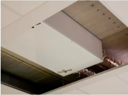
Umístění jednotek do podhledu
