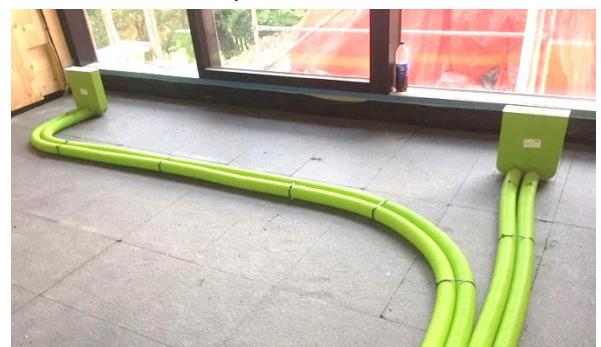
Rozvod AE v podlaze
