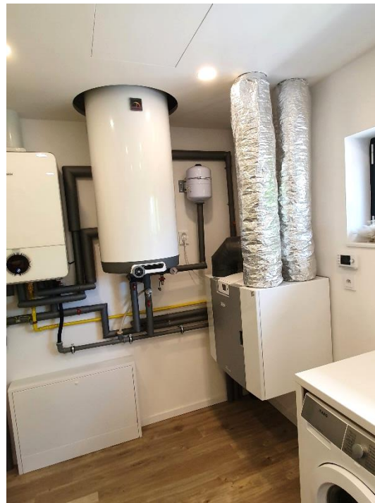
Přiznaný flexibilní tlumič mezi větrací jednotkou a VZT rozvodem v podhledu.
