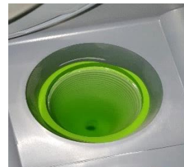
Hladké potrubí přístupné z rozdělovacích boxů a tvarovek
