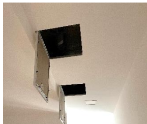
Revizní otvoru pro rozdělovací boxy
