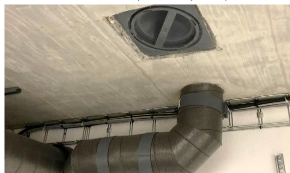
Napojení AE rozvodu s DBoxem osazeným v litém betonovém stropě na rozvod Aerfoam
