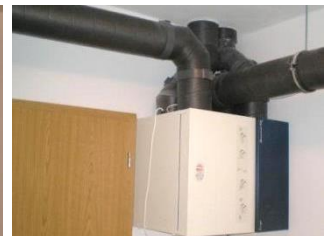
Potrubí vypadá velmi dobře a je vhodným řešením jak pro pohledová potrubí v interiéru, tak pro přívod a odvod chladného vzduchu.
