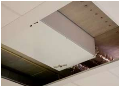
Umístění jednotek do podhledu
